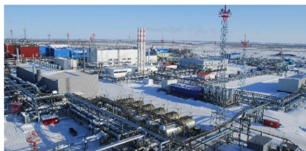
Дожимная компрессорная станция на УКПГ-2С Заполярного НГКМ
